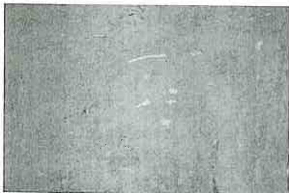
Detalle de daños mecánicos en aplanado antiguo.
